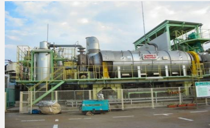
竹チップ発電設備
